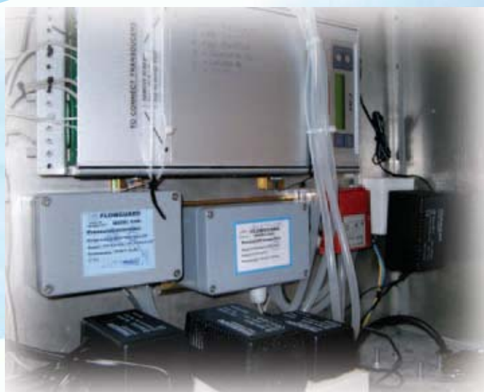
Skap med måleutrustning.
