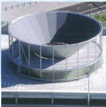
Luftinntaket til ekspedisjonsbygget.
