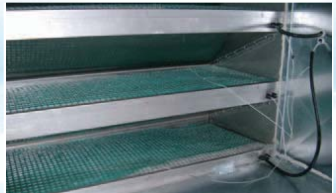
Måleutstyr koblet til inntaksristen, sett innenfra aggregatet.
