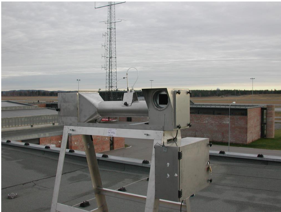
Fig. 1 viser bilde av filterrigg på Gardermoen.
