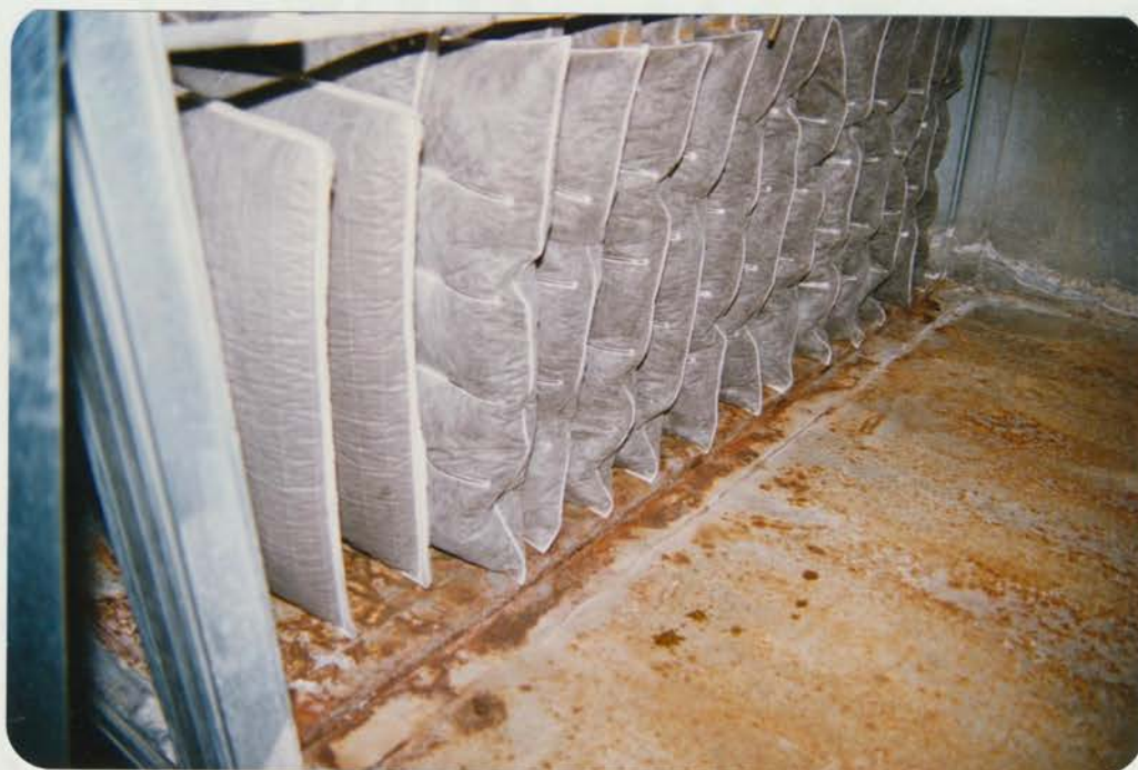
Fig. 2 Korrosjonsangrep i bunnen av ventilasjonssystem nr. 36.03 ved Flesland Lufthavn
