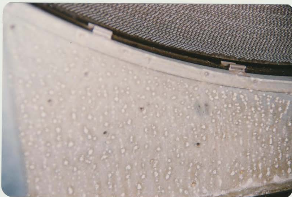
Fig. 1 Korrosjonsangrep på galvanisert plate rundt varmegjenvinneren (Hansa)
